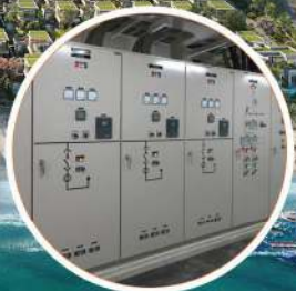
HỆ THỐNG TỦ ĐIỆN TRUNG - HẠ THỂ KHU NGHỈ DƯỠNG VINACAPITAL HỘI AN Vinacapital Hoi An Resort
