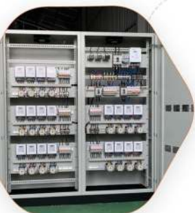
TỦ BẢNG ĐIỆN TRUNG - HẠ THỂ
